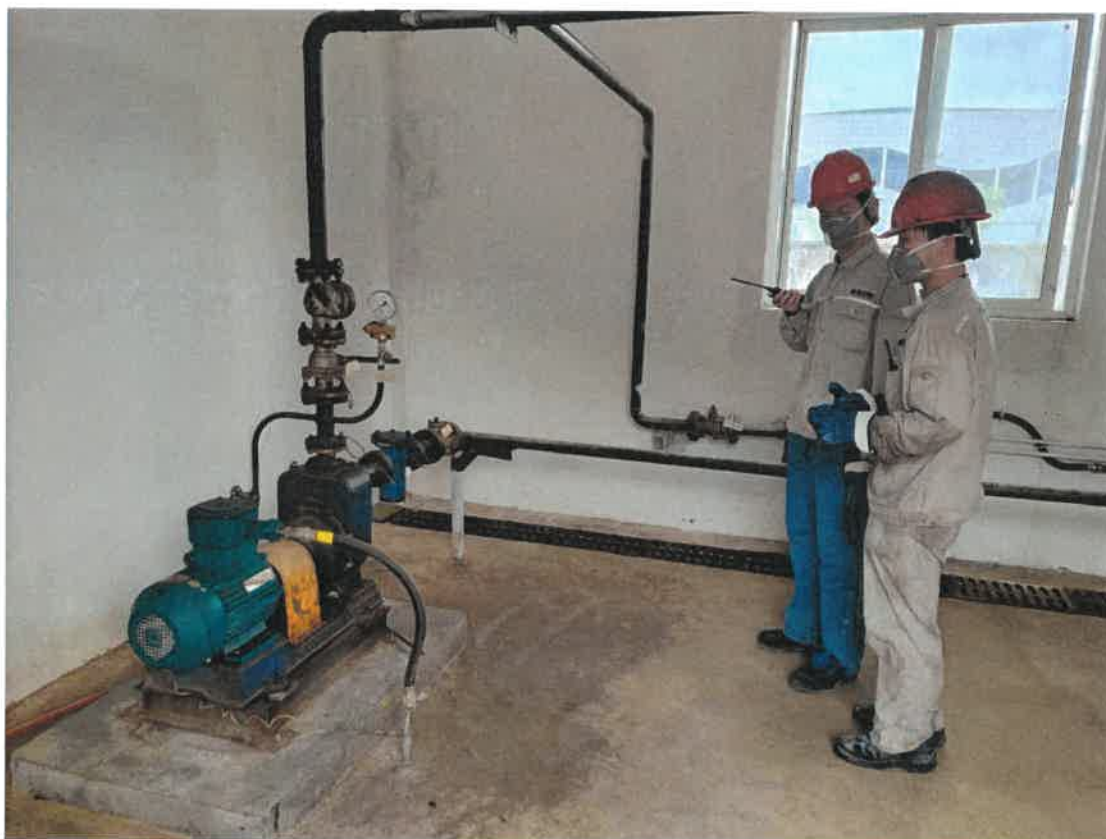
图二 焚烧班组巡查人员发现柴油泵泄露
